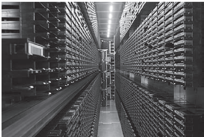
Abb 4 Innenleben eines Storage-Containers; auf den Schienen laufen die Tape-Roboter, die die Bandkassetten zu den Lesegeräten bringen
